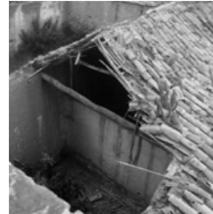
Colapso de cubierta. Palacete de la Florida – Chuquisaca, Bolivia
