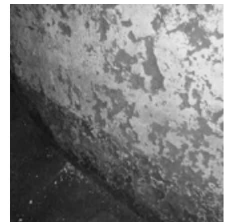
Desprendimiento de pintura a la cal. Pasillo convento de Santa Clara – Sucre – Chuquisaca, Bolivia
