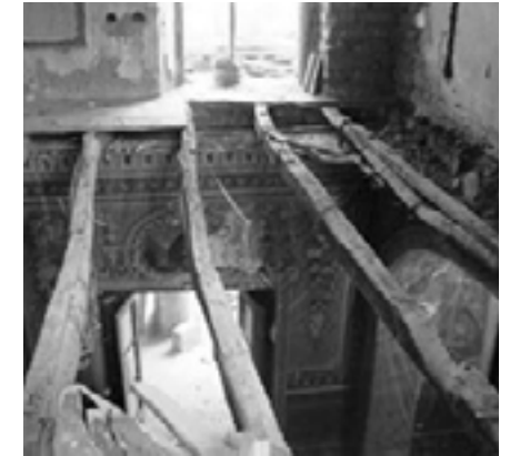
Alabeo de vigas. Palacete de la Florida – Chuquisaca, Bolivia
